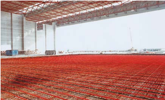
Abb. 06-1 Flächenheizung in einer Industriehalle
